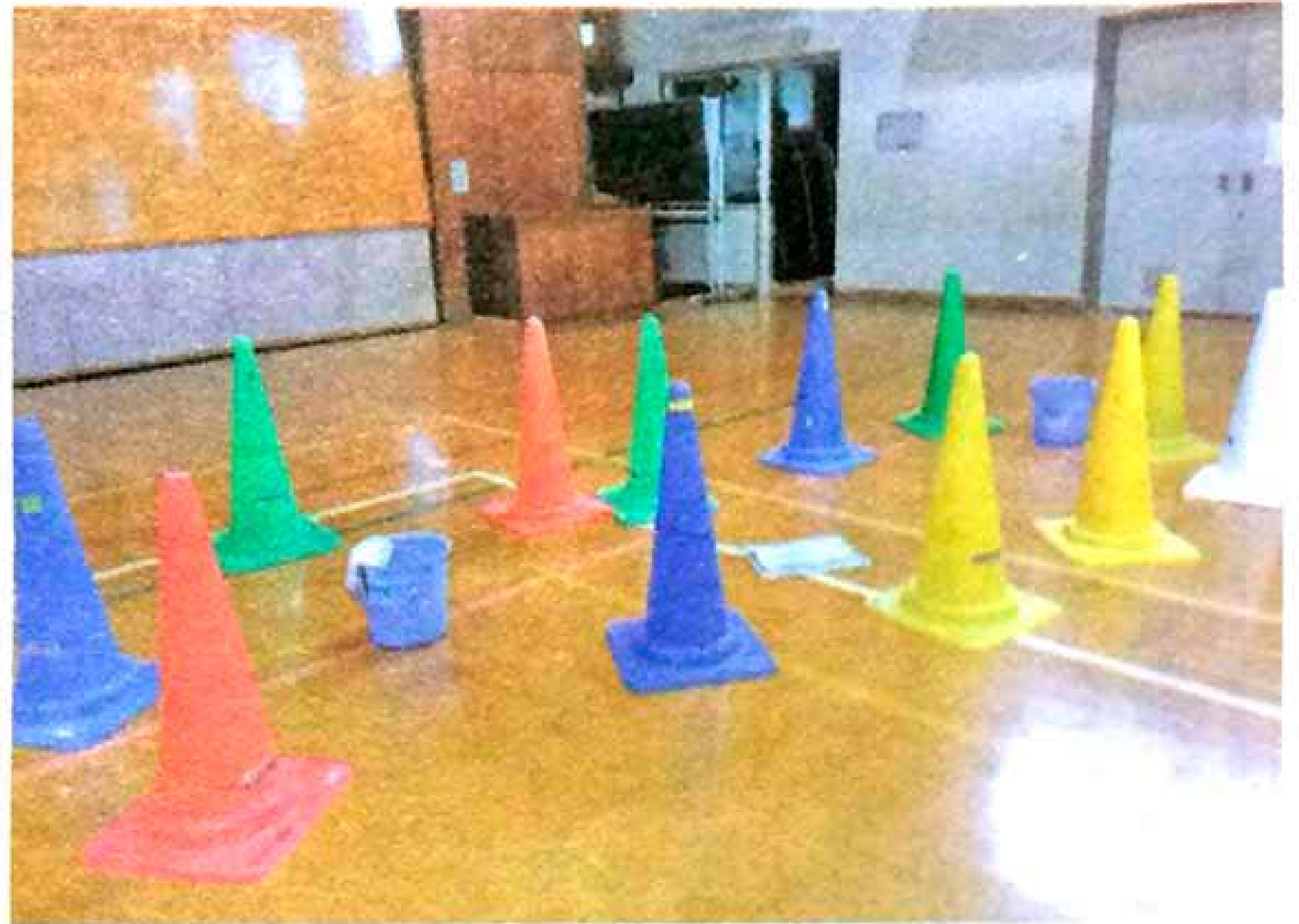
避難所となっているにもかかわらず、雨漏りしていた上京区の京極小学校体育館 (6日)
